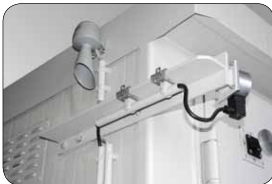
- Ex-geschützte Abluftüberwachung mit Signalhupe - Türhalteanlage
