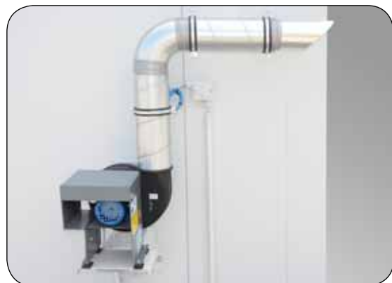
Ex-geschützter Abluftventilator inkl. Abluftüberwachung
