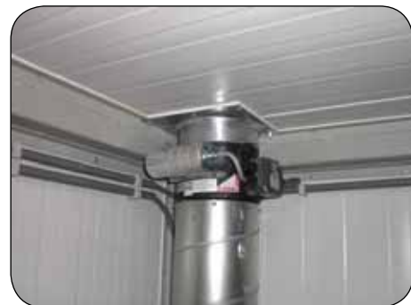
Abluftkanal mit K-90 Absperrvorrichtung
