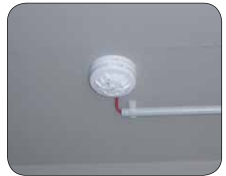
Rauchmelder zur Ansteuerung der Türfeststellanlage
