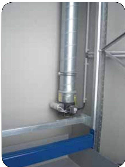
Ex-Abbluftanlage inkl. brandgeschützter Lüftungselemente
