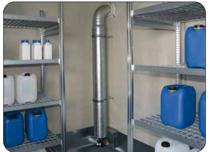
Ex-Abluftanlage inkl. Abluftkanal bis Auffangwanne
