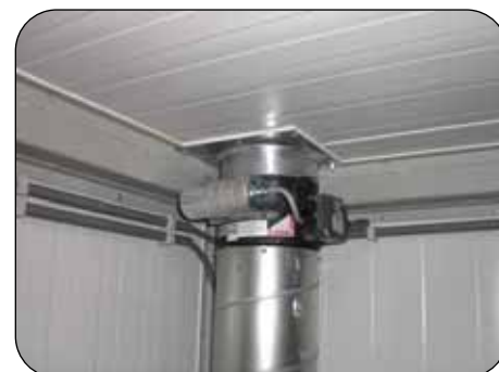
Abluftkanal mit K-90 Absperrvorrichtung
