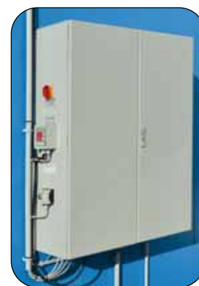
Schaltschrank mit zentraler Steuerung und Bedienelementen
