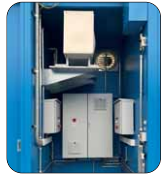
◆ Zentrale Steuereinheit (Schaltschrank, E-Unter-verteilung, Kühlaggregat)
