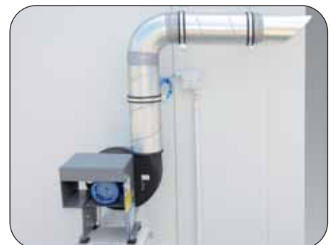
Ex-geschützter Abluftventilator inkl. Abluftüberwachung
