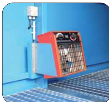
Umluftheizung nicht Ex-geschützt
