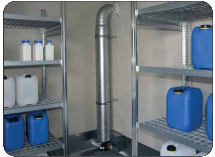
Ex-Abluftanlage inkl. Abluftkanal bis Auffangwanne
