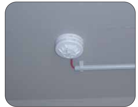
Wärmemelder zur Ansteuerung der Türfeststellanlage
