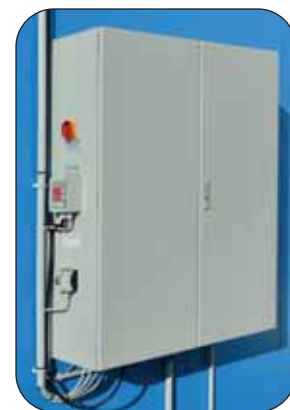
Schaltschrank mit zentraler Steuerung und Bedienelementen
