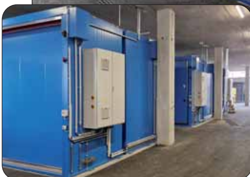
◆ Brandschutzcontainer wurden im Gebäudekomplex (Erdgeschoss) integriert
