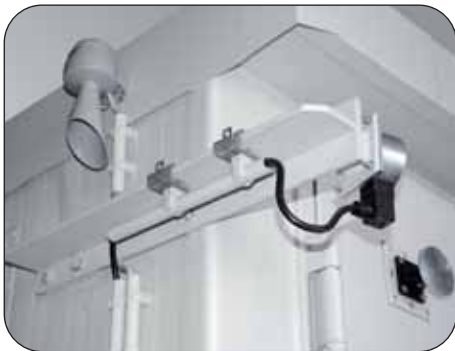
- Ex-geschützte Abluftüberwachung mit Signalhupe - Türhalteanlage
