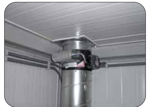
Abluftkanal mit K-90 Absperrvorrichtung
