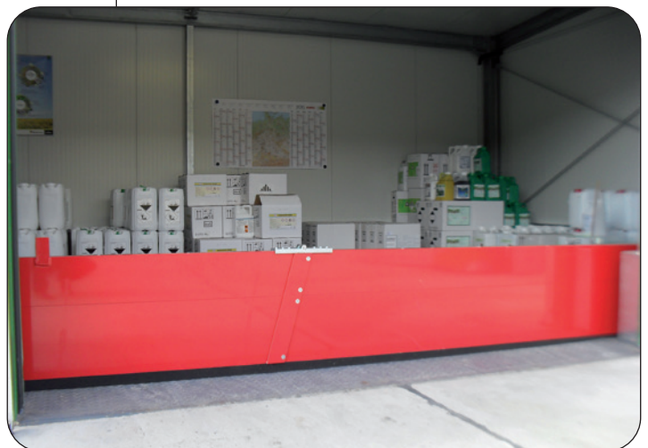
Löschwasserrückhaltung mit dreh-klappbarer Barriere
