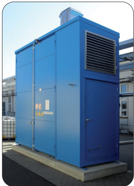
Thermo-Wasserschutz-Fachcontainer mit separatem Technikraum
