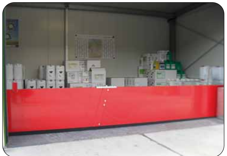
Löschwasserrückhaltung mit dreh-klappbarer Barriere
