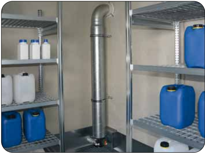
Ex-Abluftanlage inkl. Abluftkanal bis Auffangwanne
