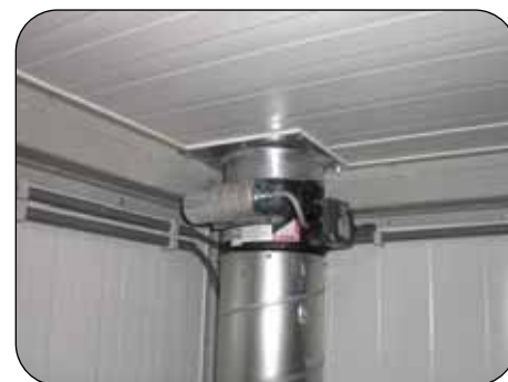
Abluftkanal mit K-90 Absperrvorrichtung
