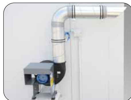
Ex-geschützter Abluftventilator inkl. Abluftüberwachung
