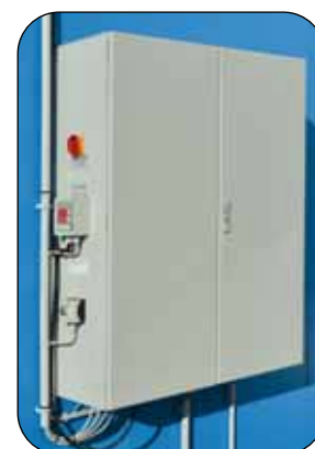
Schaltschrank mit zentraler Steuerung und Bedienelementen
